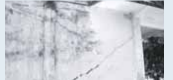
スワイチュルム小学校旧校舎。壁に大きなひびが入っていた。
